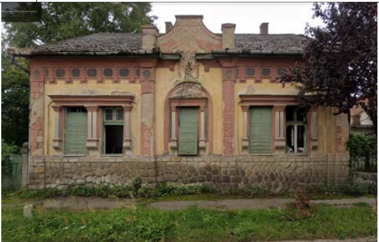
F04 | Az utcai homlokzat leromlott állapota (2021)
