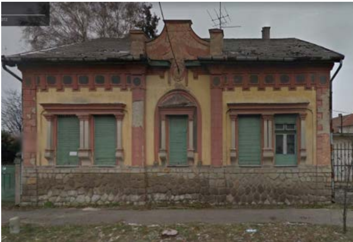
F01 | Az utcai homlokzat romló állapota (2012)
